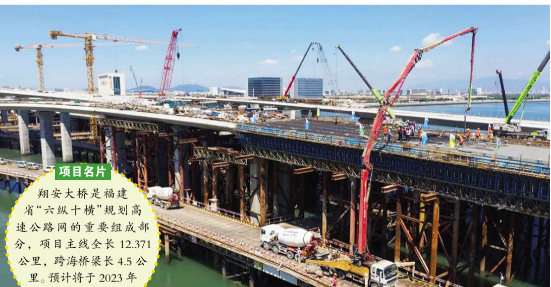
翔安大桥环岛东路互通 F 匝道第九联最后一方混凝土进行浇筑作业。(林铭鸿 / 摄)
