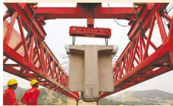
11月8日,翔安机场高速公路内头大桥,首片预制T梁成功架设(王协云/摄)
